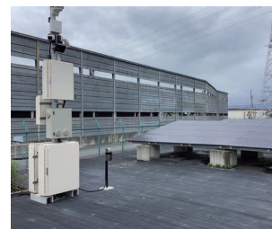
監視カメラ・警報機等の設置
