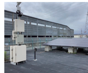
監視カメラ・警報機等の設置
