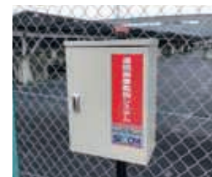
遠隔画像監視システムの導入
