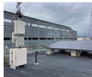
監視カメラ・警報機等の設置
