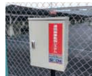
遠隔画像監視システムの導入
